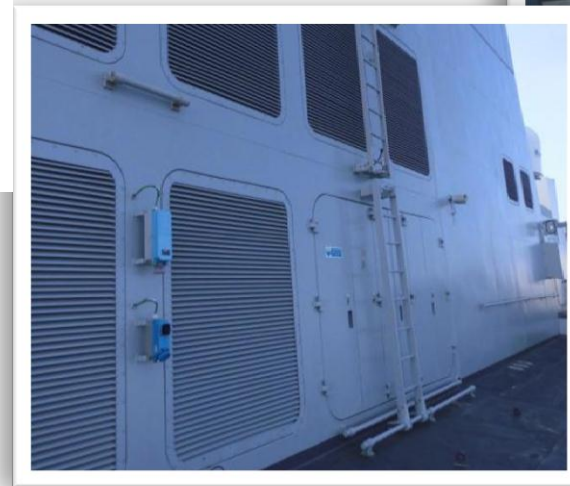
Installazione a bordo griglia di ventilazione
